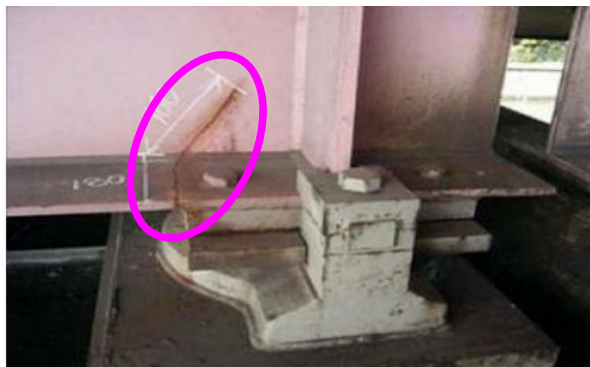
主桁の疲労き裂
