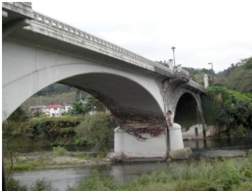
(a) 大橋 (広瀬川) — 塞がったスパンデル部
